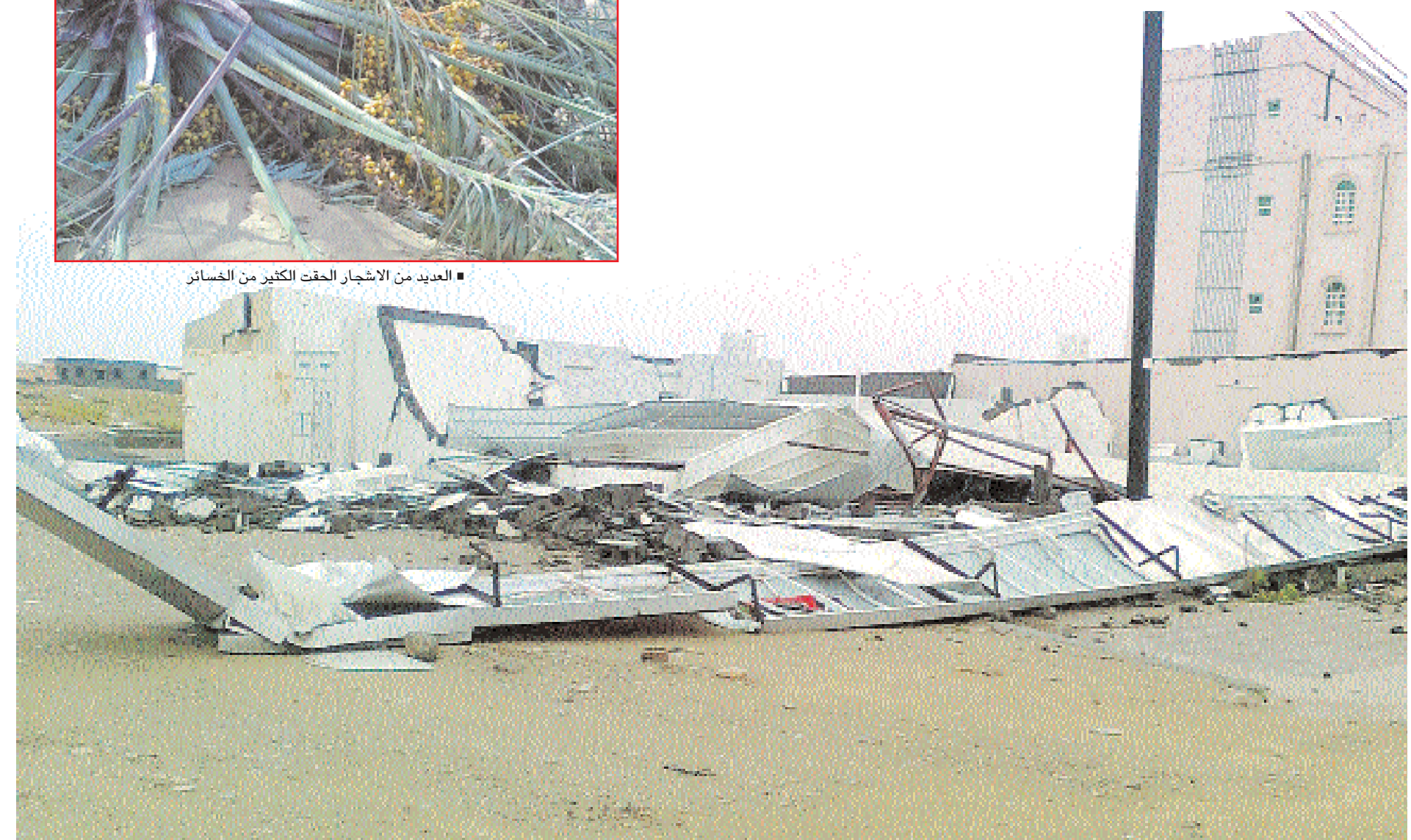
■ هذا النوع من الحديد (البيت) سقط لعدم البناء بالطريقة السليمة
