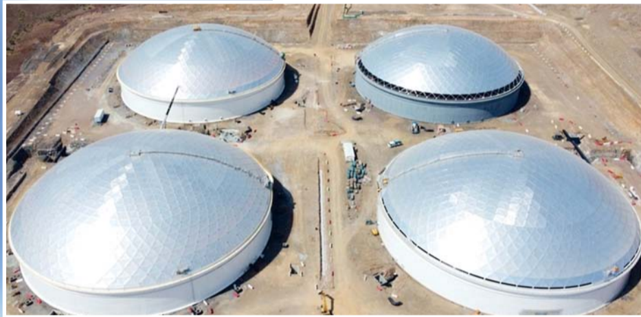
■ مشروع خط المياه «الدقم - هيماء» يتضمن خزانات توزيع بسعة تخزينية تصل إلى ٨٠٠٠ متر مكعب تقريباً
